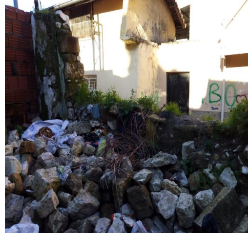
Görsel 25: Mutfağın içine çökmüş duvarları
